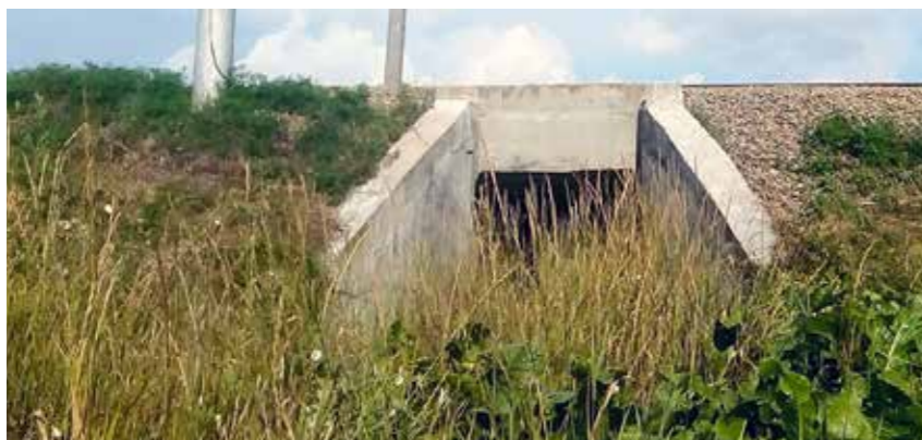
Тоннель под ж/д полотном соединяет микрорайон Западный с Солоней. Фото Елены Бутенко.
